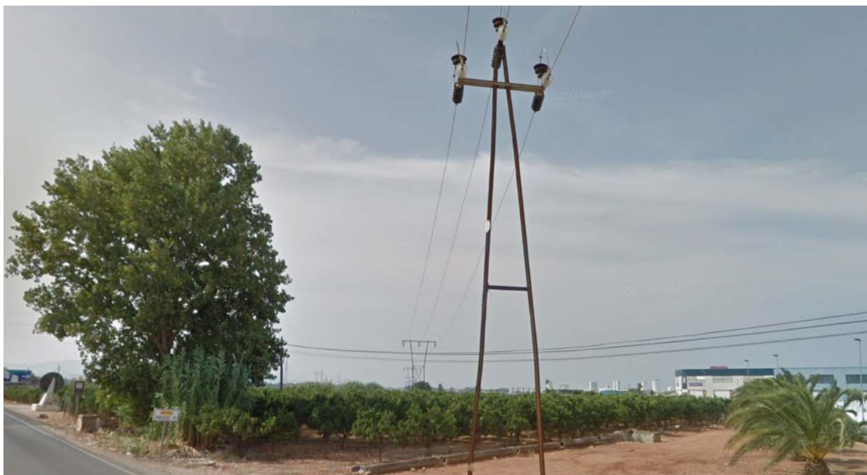
Suports de la línia elèctrica Gandia-Oliva-El Verger.
