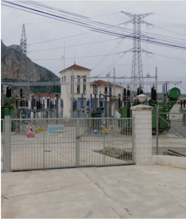
Sub-estació del Verger.
