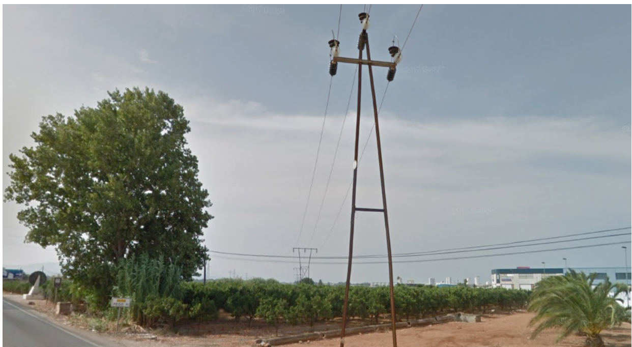
Suports de la línia elèctrica Gandia-Oliva-El Verger.
