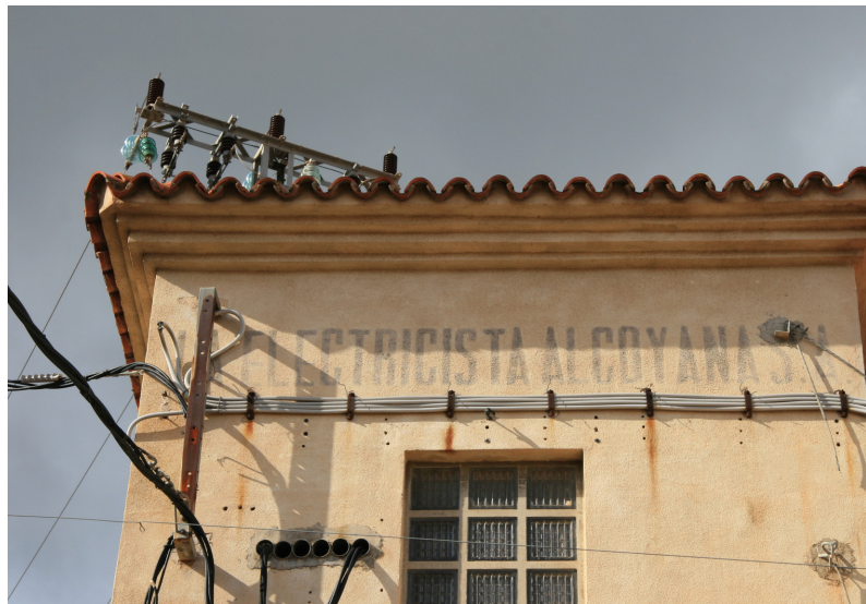
Transformador de Pedreguer construït per Santonja. Fotografia: JUAN CABRERA
