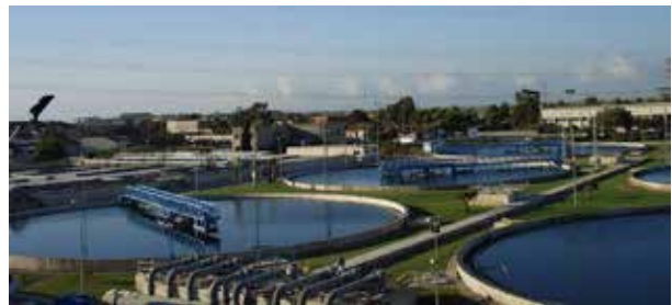
Figura 2. Depuradora de Pinedo (València). Font: Aguas de Valencia.
